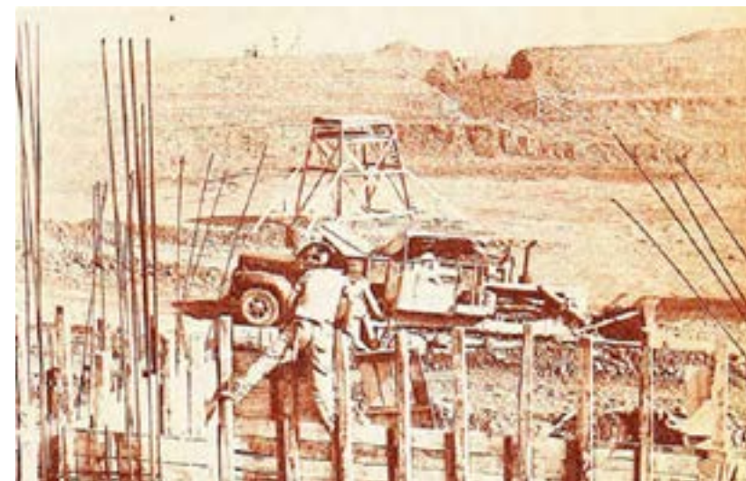
Figura 3 Avances en la construcción del velódromo del Estadio Nacional (1965) Nota. Sillines y cadenas(b), 1965, p. 31.
